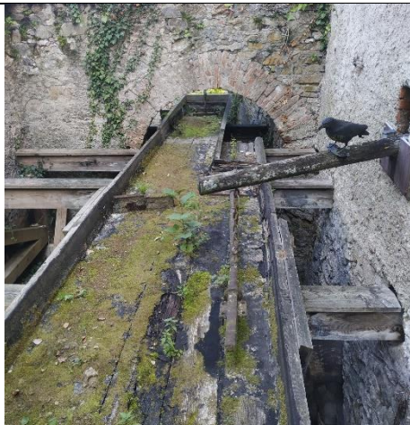
Blick von oben auf das vermorschte Fluder (wasserführendes Gerinne)
