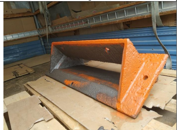
Gusseisentrichter des Wasserrades Durch das Sandstrahlen werden die tiefen Korrosionsspuren sichtbar.
